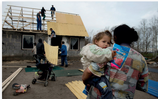
▶ Antal András atya katolikus lelkipásztor és önkéntes segítők felújítják egy négygyermekes asszony víz és villany nélküli házának rozoga tetőszerkezetét
